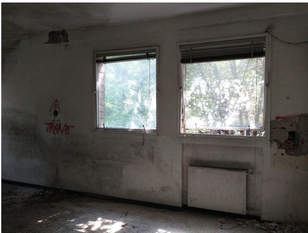
Foto 11: Fabbricato ex giudice di pace – interno piano secondo
